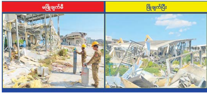
KK Parkနယ်မြေအပိုင်း(၃)တွင်တရားမဝင်ဆောက်လုပ်ထားသည့်နှစ်ထပ်လူနေအဆောက်အအုံများအား လေအိုးမီးအိုးဖြင့် ဖျက်ဆီးနေမှုကို တွေ့ရစဉ်။
