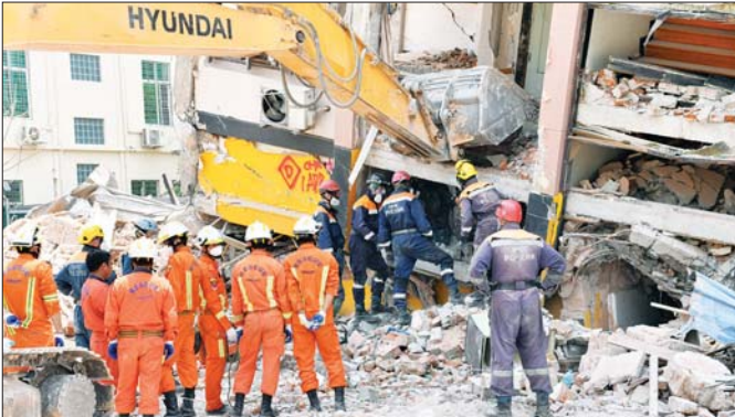
ရှာဖွေနိုင်ငံမှ ရှာဖွေကယ်ဆယ်ရေးအဖွဲ့ဝင်များက မန္တလေးမြို့ ငလျင်ဘေးသင့်အဆောက်အအုံများ အတွင်း ကူညီကယ်ဆယ်ရေးလုပ်ငန်း ဆောင်ရွက်စဉ်။ (၃-၄-၂၀၂၅)
