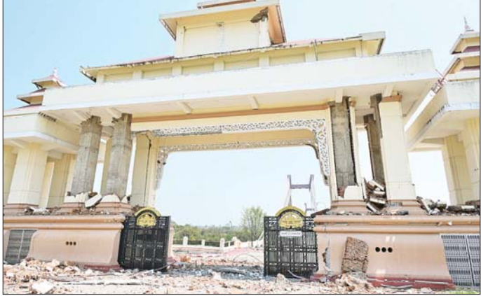
ငလျင်ဘေးဒဏ်ကြောင့် လွှတ်တော်အဆောက်အအုံ မုခ်ဦးထိခိုက်ပျက်စီးမှုကို တွေ့ရစဉ်။
