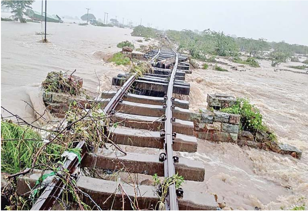
သာစည်-ရွှေညောင်လမ်းပိုင်း၊ လှိုင်းတက်နှင့်ဘုရားငါးဆူကြား တံတားရေတိုက်စားမှုအခြေအနေကိုတွေ့ရစဉ်။
