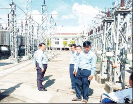
မီဒါသုံးခုဖြင့် ဓာတ်အားပေးထားမှုအခြေအနေများကို ကြည့်ရှုစစ်ဆေးကာ လိုအပ်သည်များ ဖြည့်ဆည်းဆောင်ရွက် ရှိသည့်(၂၃၀/၆၆) ကေစီ ၁၅၀ အမီစီအေ ထရန်စဖော်မာ တည်ဆောက်ပြီးစီးမှု ချစ်ဆောင်
