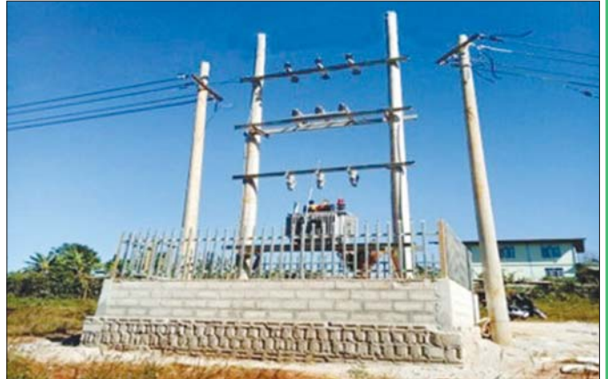
နယ်စပ်ရေးရာဝန်ကြီးဌာနက တာဝန်ယူဆောင်ရွက်ပေးခဲ့သည့် မဲနယ်တောင်တန်းဒေသ၊ ကျောက္ကရာ-ကျေးရွာ လျှပ်စစ်ဓါတ်အား ဆောင်ရွက်ပြီးစီးမှု။
