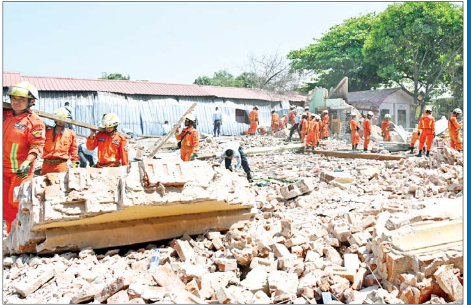
နေပြည်တော် ပျဉ်းမနားမြို့ မေမာသီဝံကျောင်းတိုက်အတွင်းရှိ ဓမ္မာရုံတော် ငလျင်ဘေးဒဏ်ကြောင့် ပြိုကျပျက်စီးခဲ့မှုအား မတ် ၃၀ ရက်က ကူညီကယ်ဆယ်ရေးနှင့် အပျက်အစီးများ ဖယ်ရှားရှင်းလင်းခြင်း လုပ်ငန်းများ ဆောင်ရွက်နေမှုကို တွေ့ရစဉ်။
