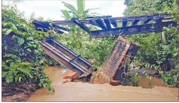
လယ်ဝေး အောက်တိုဘာ ၆ ပြည်ထောင်စုနယ်မြေ လယ်ဝေးမြို့နယ်အတွင်း မိုးသည်းထန်စွာ ရွာသွန်းပြီး ချောင်းရေတိုက်စား မှုကြောင့် ယမန်နေ့ မွန်းလွဲပိုင်းက လယ်ဝေး- ဒလန့်ချွန်သွား ရထားလမ်း၊ ကွင့်ကြီးမြောင်း ချောင်းကူးတံတား၊ တံတားအမှတ် ၁၄၄၊ မိုင်တိုင် အမှတ် ၂၆/၆၇၊ ၂၄ ပေအရှည် တံတားကျိုးကျပျက်စီး ခဲ့သည်။ အဆိုပါ တံတား ကျိုးကျပျက်စီးရာနေရာသို့ မီးရထားတိုင်း (၅) မှ အင်ဂျင်နီယာမှူး ဦးအောင် မြင့်နိုင်နှင့်အဖွဲ့က ယမန်နေ့ ညနေပိုင်းမှစတင်၍ ပြင်ဆင်ခြင်းများ ဆောင်ရွက်လျက်ရှိကြောင်း သိရ သည်။
