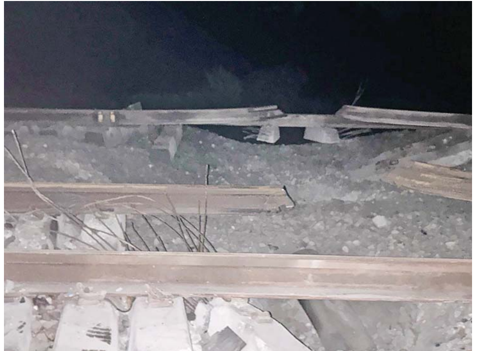
ညောင်ပင်သာနှင့် ဖြူးဘူတာကြား မိုင်းပေါက်ကွဲမှုကြောင့် ရထားလမ်းနှင့် ကွန်ကရစ်လီဖာတုံးများ ပျက်စီးဆုံးရှုံးမှုအခြေအနေကို တွေ့ရစဉ်။
