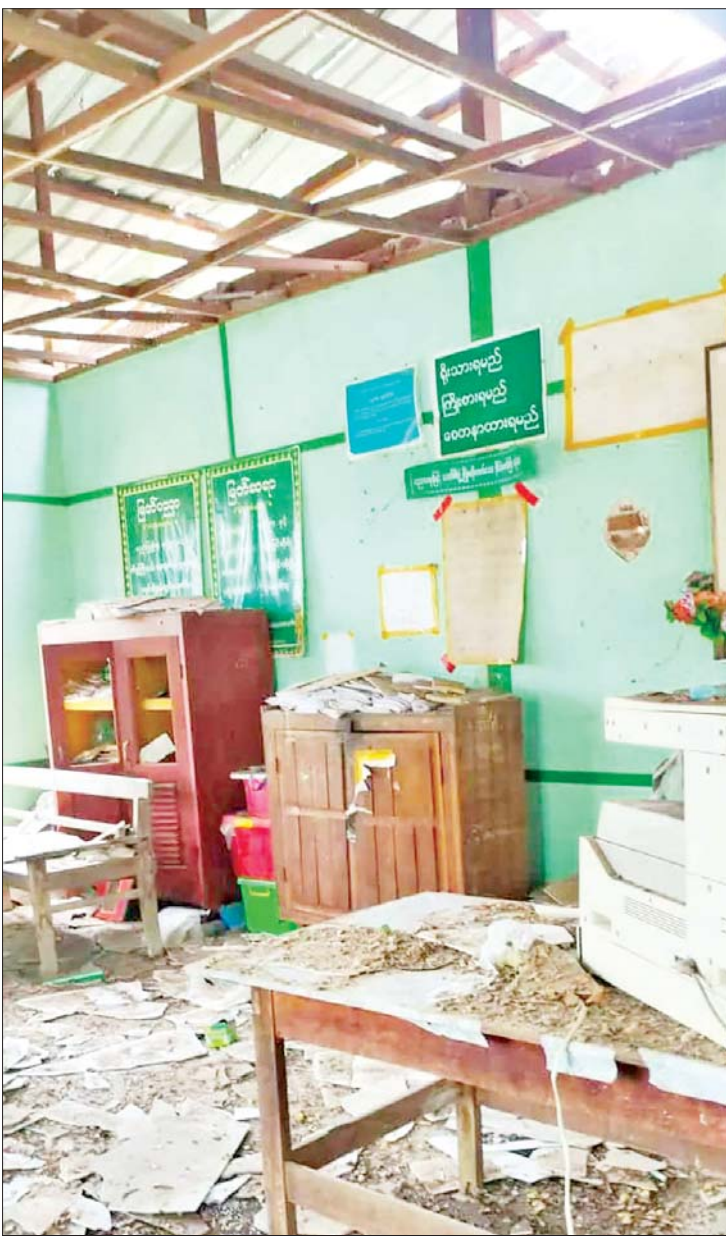
စစ်ကိုင်းတိုင်းဒေသကြီး ဒီပဲယင်းမြို့နယ် အိုးထိမ်းကွင်းကျေးရွာစာသင် ကျောင်း၌ မေ ၁၂ ရက်က PDF အမည်ခံ အကြမ်းဖက်သမားများ၏ လက်လုပ်ခိုင်းများ ပေါက်ကွဲမှုကြောင့် စာသင်ကျောင်းအဆောက်အအုံ ထိခိုက်ပျက်စီးမှုကို တွေ့ရစဉ်။ (ထိုဖြစ်စဉ်ကို လေကြောင်းဖြင့် ဗုံးကြဲတိုက်ခိုက်သည်ဟု ပြည်ဖျက်မီဒီယာများက မဟုတ်မမှန်ရေးသားထုတ်လွှင့်ခဲ့ကြသည်။)
