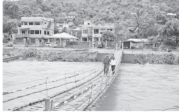
တြိဂံဒေသတိုင်းစစ်ဌာနချုပ် တိုင်းမှူး ဗိုလ်မှူးချုပ်စိုးလှိုင် လွယ်တော်ခမ်းကျေးရွာရှိ မယ်ဆိုင်ချောင်းကူးတံတားပျက်စီးမှုနှင့် ယာယီတံတားဆောက်လုပ်ထားရှိမှုတို့ကို ကြည့်ရှုစစ်ဆေးစဉ်။
