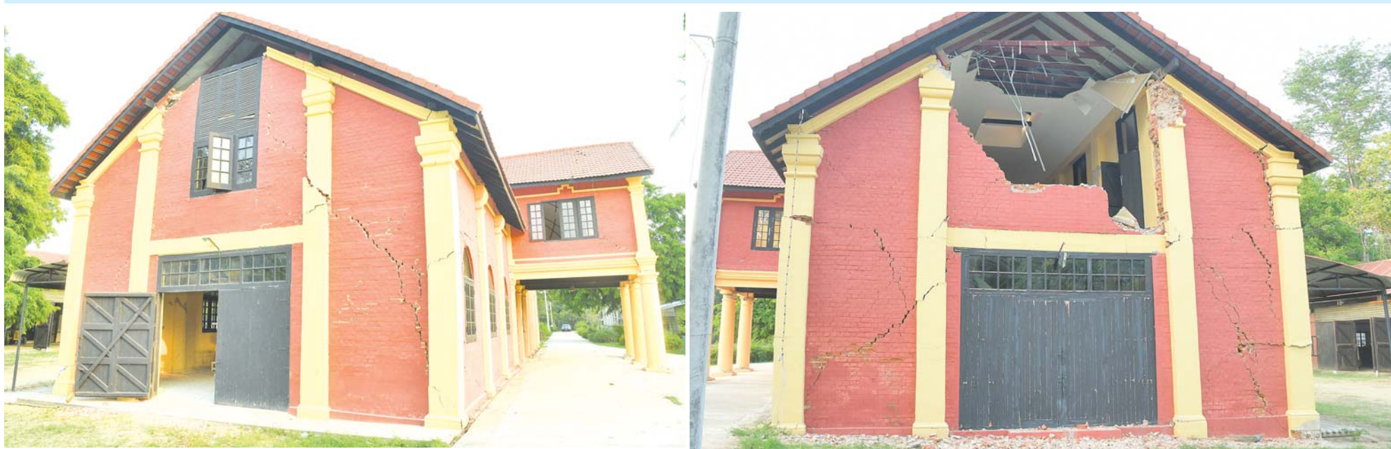
စိုက်ပျိုးရေးနှင့်မွေးမြူရေးသိပ္ပံ(ပျဉ်းမနား)ရှိအဆောက်အဦများ ငလျင်ဒဏ်ကြောင့်ထိခိုက်ပျက်စီးမှုအခြေအနေများကို တွေ့ရစဉ်။
