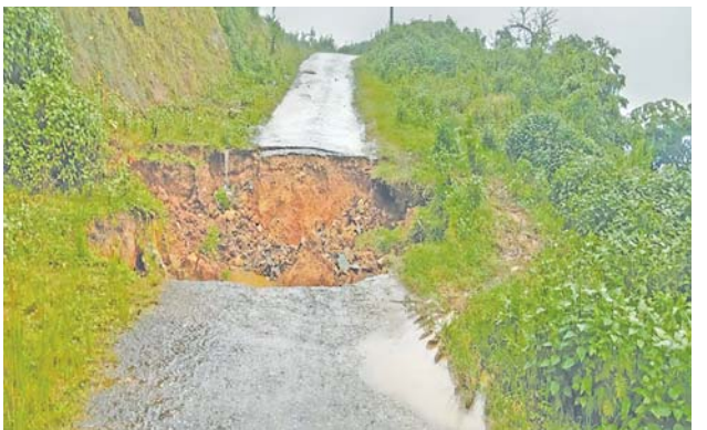
မိုးကုတ်မြို့နယ်၊ ကျောက်ဆင်ကျေးရွာနှင့်ဘော်မားကျေးရွာသွား ကတ္တရာလမ်း၌ မြေကျွဲပျက်စီးမှုကိုတွေ့ရစဉ်။
