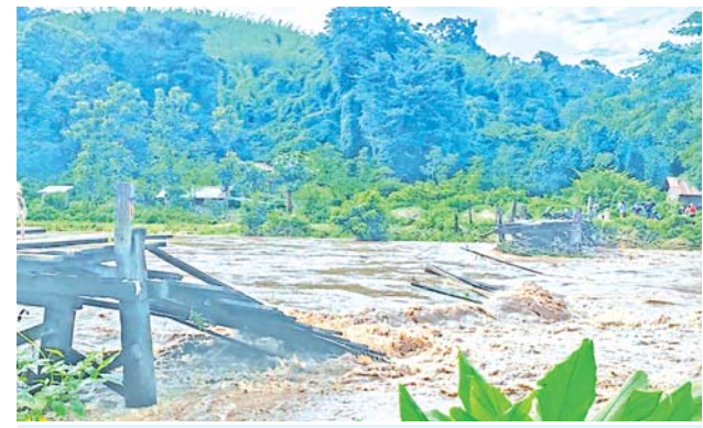
ကင်းရွာနှင့်ရွှံ့တောရွာကြားရှိ သစ်သားတံတား ရေနောက်မျောပါပျက်စီးမှုကိုတွေ့ရစဉ်။
