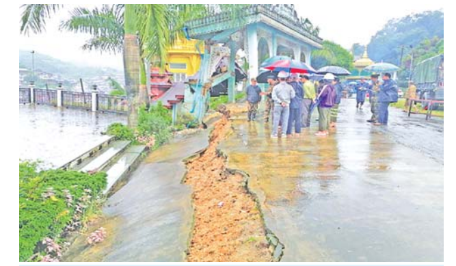
မိုးကုတ်မြို့၊ ဖောင်တော်ဦးကျောင်းတိုက်အနီးရှိ တောင်မြေကျမှုကြောင့် ဘုရားရင်ပြင်၊ စောင်းတန်းနှင့်မြေထိန်းနံရံ(အင်္ဂတေကျောက်စီ) ကွဲအက်နေမှုကိုတွေ့ရစဉ်။
