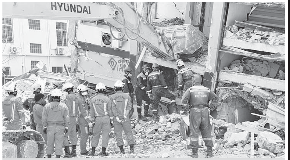
ရုရှားနိုင်ငံမှ ရှာဖွေကယ်ဆယ်ရေးအဖွဲ့ဝင်များက မန္တလေးမြို့ ငလျင်ဘေးသင့်အဆောက်အအုံများအတွင်း ကူညီကယ်ဆယ်ရေးလုပ်ငန်းဆောင်ရွက်စဉ်။
